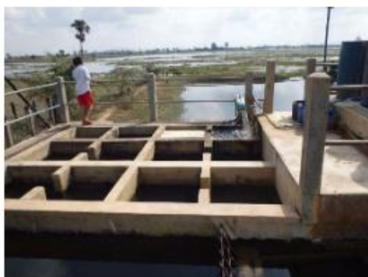
字流式沈殿池
